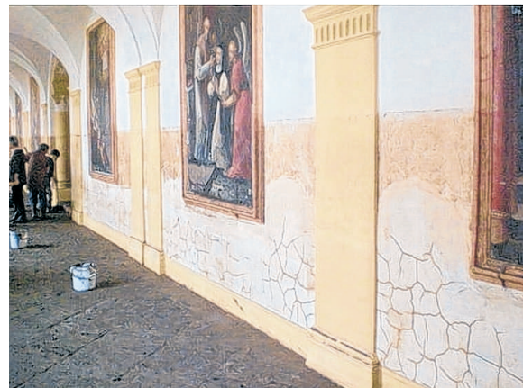
Wie hoch das Wasser in der Zisterzienserinnenabtei St. Marienthal stand – und was jetzt saniert werden muss, zeigt dieses Bild. Fotos (2): Bistum-Dresden/Thomas Bönisch
